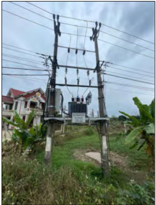
1 TRẠM BIẾN ÁP TRẠI BẦU 1
