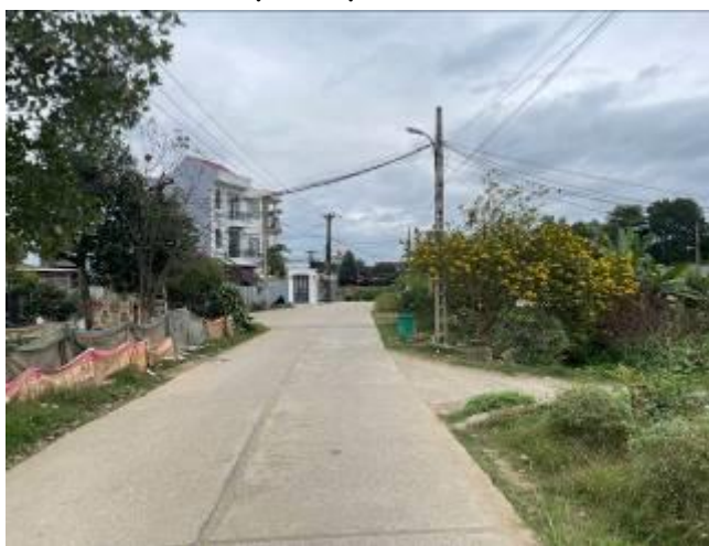
Đường điện trung thế, hạ thế dọc đường
