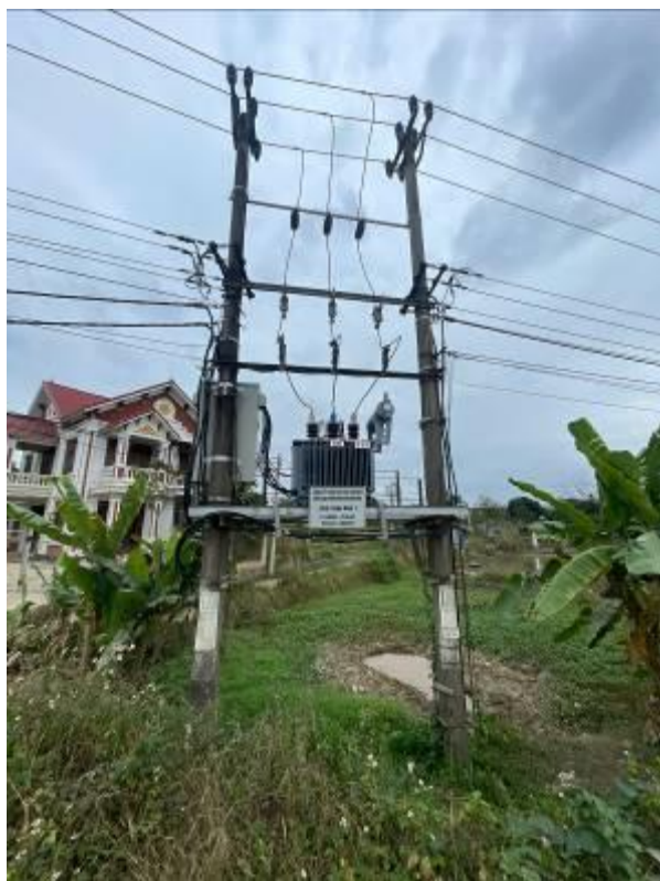
Trạm Trại Bàu 1
