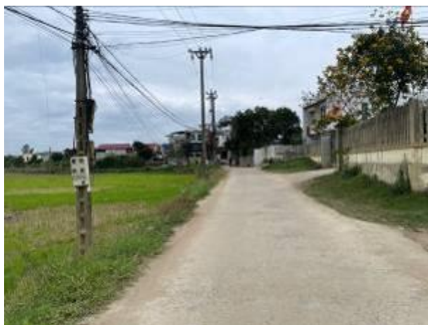
Tuyến cáp quang đi cùng cột điện hạ thế
