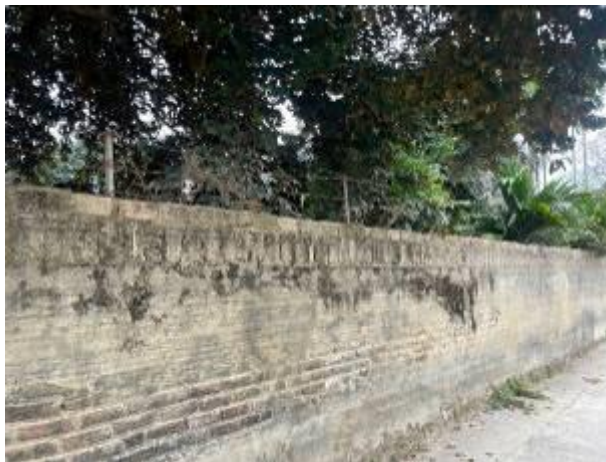
Vết nước lũ ngập tại khu vực dự án
