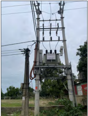
2 TRẠM BIẾN ÁP TRẠI BẦU 3
