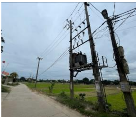
Trạm Trại Bàu 2
