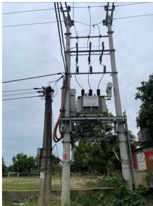
Trạm Trại Bàu 3
