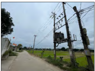
3 TRẠM BIẾN ÁP TRẠI BẦU 2
