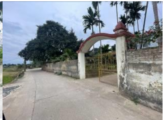
Theo khảo sát hiện trạng nước ngập đến cổng nhà dân
